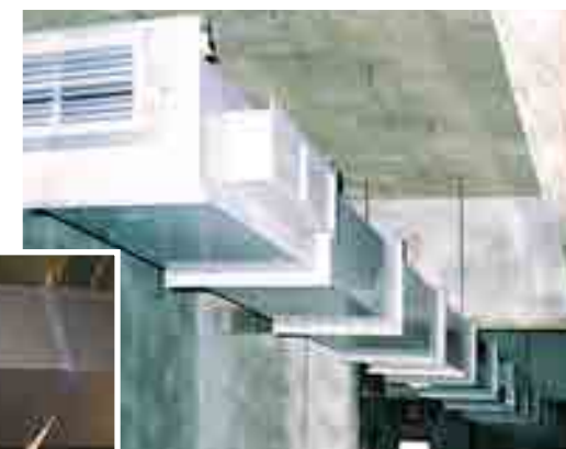
●下水処理場 脱臭ダクト(S.S.D)
